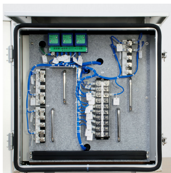
外線接続側実装写真
