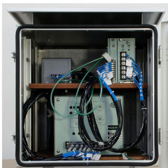
機器収納側実装写真
