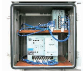
【機器収納側実装写真】
