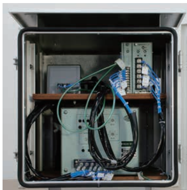
【機器収納側実装写真】
