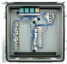
【外線接続側実装写真】
