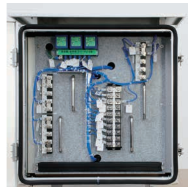
【外線接続側実装写真】
