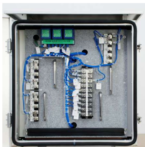
外線接続側実装写真
