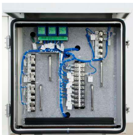
外線接続側実装写真
